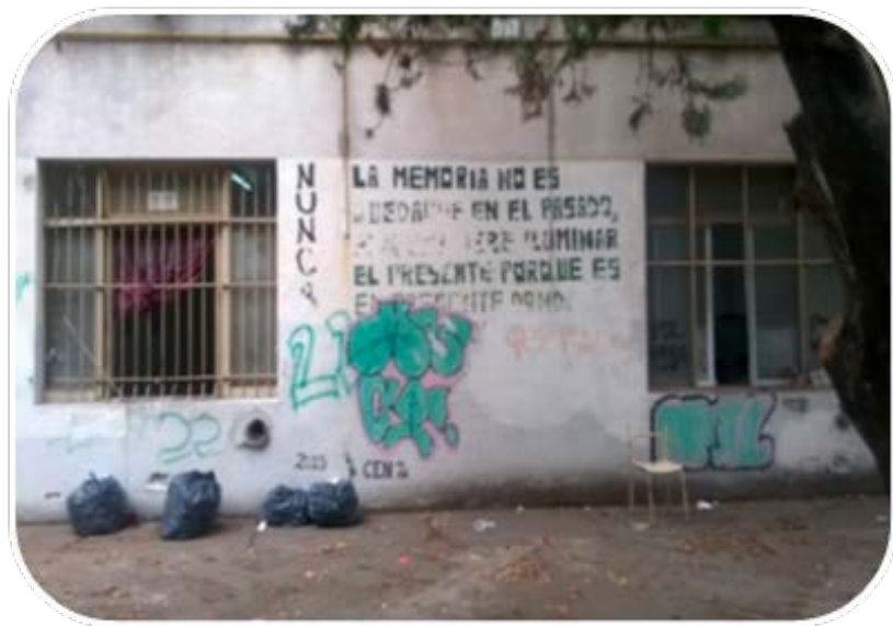
Imagen 6. Mural sobre pared del patio abierto en mal estado
